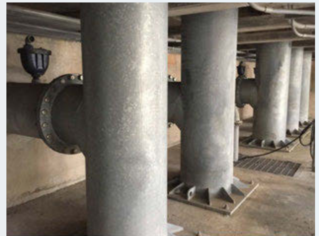
Tubería de Descarga de Bombas
