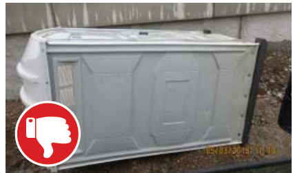
El baño portátil se ancló incorrectamente y se cayó. Asegúrese de que los derrames de residuos y químicos se remuevan correctamente.
