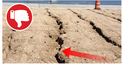
BMP fallida: el agua pluvial causa la formación de sumideros, porque las medidas de estabilización de la vegetación no se implementaron correctamente. Estabilizar con matriz de fibra unida o mantas de control de erosión
