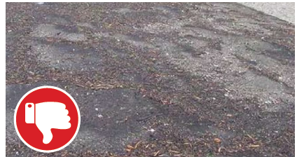
BMP fallida: el mantillo en general no es apropiado en áreas de flujo concentrado. El mantillo debe aplicarse regularmente en áreas de alto tránsito y se debe aplicar de manera uniforme y pareja y con el espesor apropiado.
